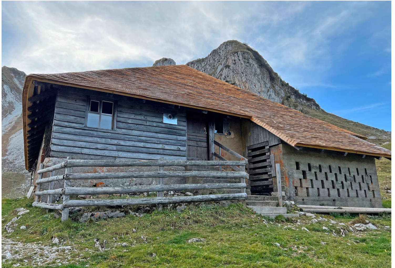
Imprägnieren oder nicht? Die frisch mit unbehandelten Schipfen eingedekte Chumliihütte im Gantrischgebiet. Das ersetzte unbehandelte Schipfendach hielt gemäss Dachdecker Marcel Brand zuvor fast 65 Jahre. Foto: PD/Marcel Brand
